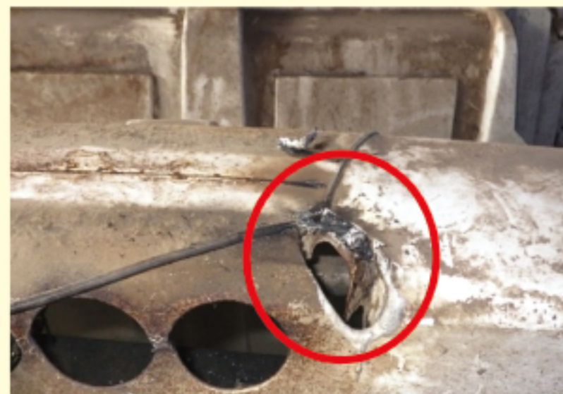
(断線したコードにより発熱し溶けている)
