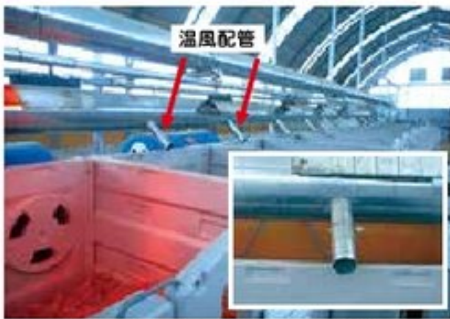
別室のボイラーから温風を送風
